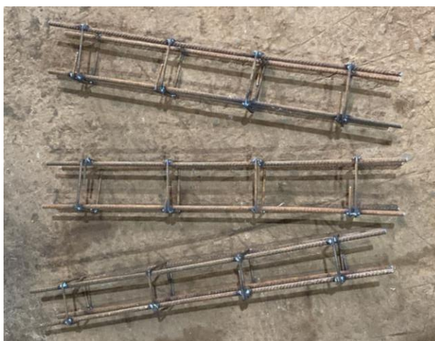
FIGURA 11 - Preparo das armaduras de aço, uso de solda para fixação dos Estribos (Fonte: Autor, 2023)
